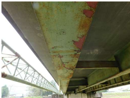
鋼桁に腐食が見られます
