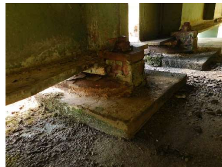
支承に腐食が見られます
