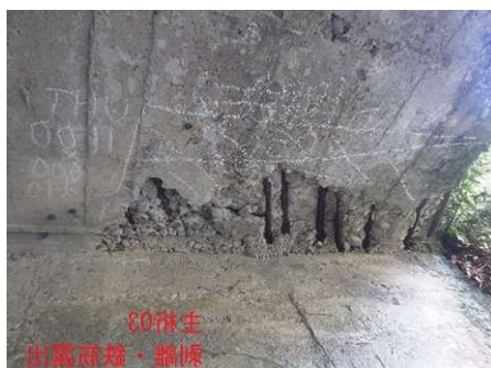
コンクリートに剥離・鉄筋露出が見られます
