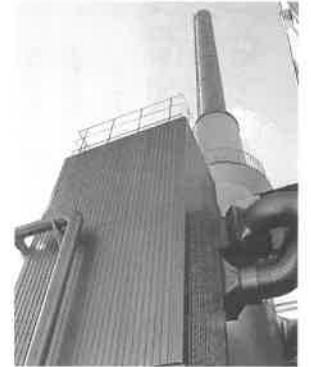
新たに設置された「バグフィルタ」
