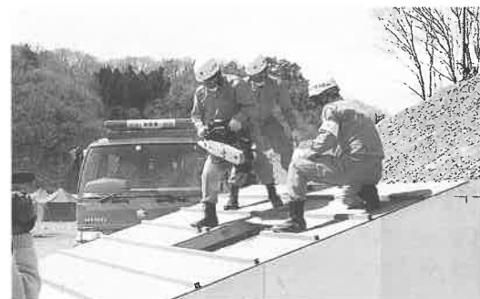
倒壊家屋から負傷者を救出する消防隊員
