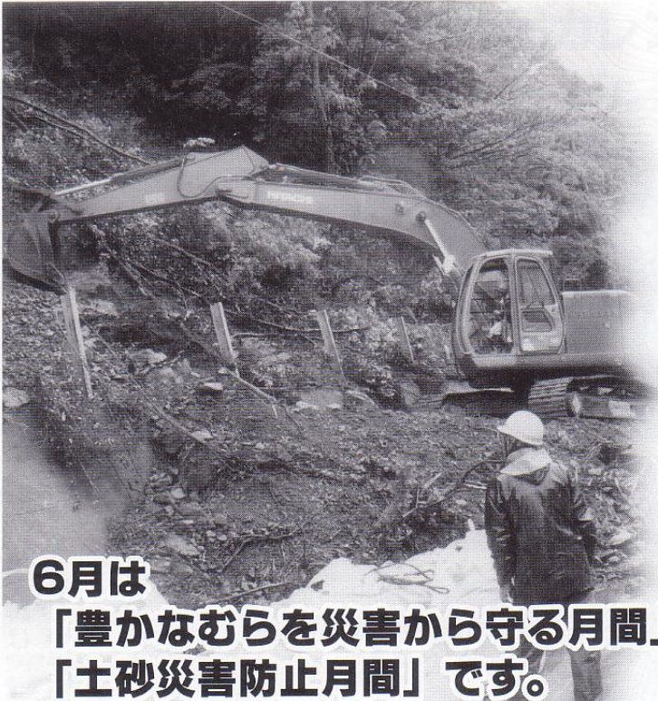
▶今年5月、国道373号線の土砂崩れ
