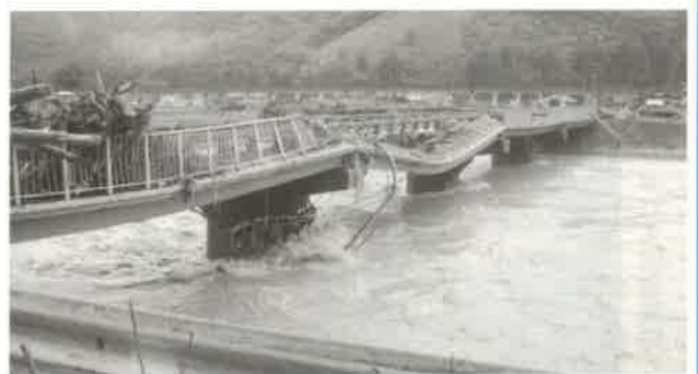
▲ 河野原橋の歩道橋破損
