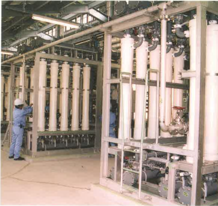
▲大枝新水源膜ろ過施設
